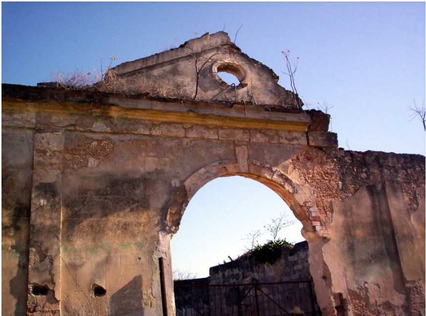
Figura 2. Almacén portuario decimonónico en desuso, provincia Matanzas (fotografía: Lissette Roura A., 2009).
